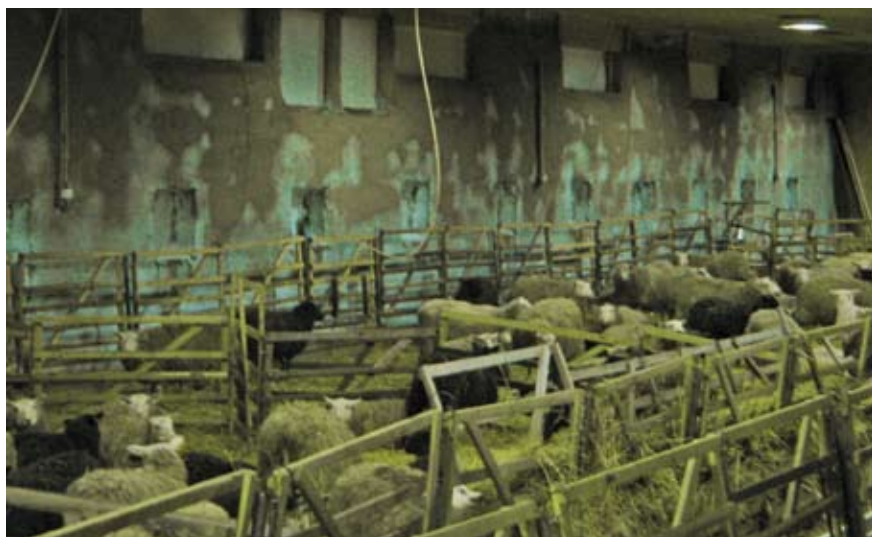
Ulkona -23 ja kova tuuli, sisällä 0 astetta. Ulkopuolen rappauksen puuttuminen kavaltaa seinässä olevat harvat kohdat.
