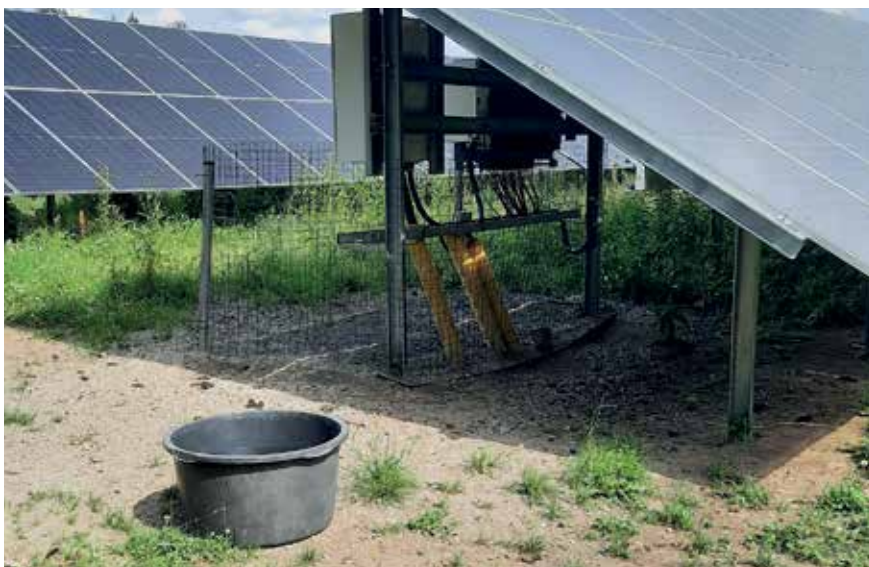
Invertterit on suojattu lampailta verkolla.
